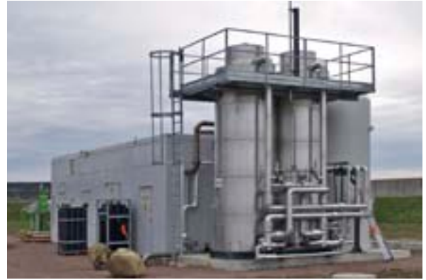
Figura 25. Fotografía del sistema de depuración de la planta de biogás Söderasens Bioenergi AB
