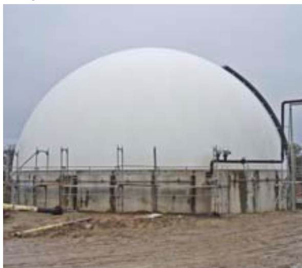
Figura 20. Gasómetro externo 1.500 m 3 (arriba) y motor de cogeneración 1,4 MWe (abajo)
