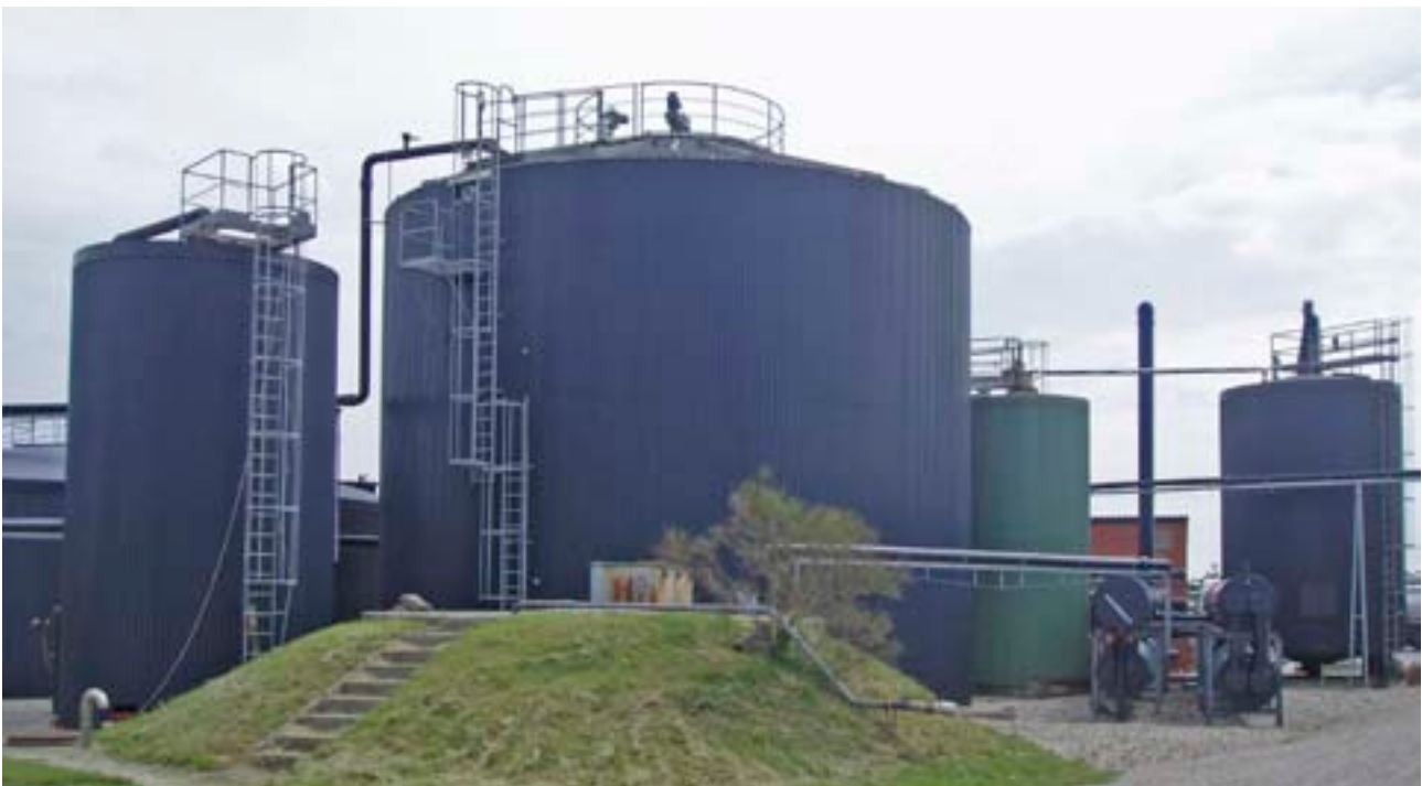
Figura 22. Vista posterior de la planta de biogás de Fangel
