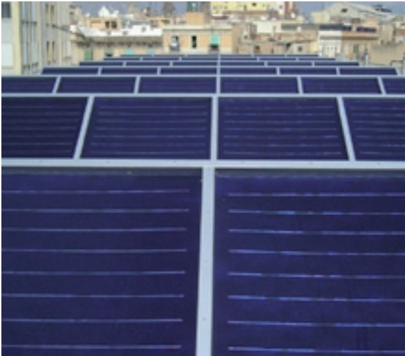
Figura 21. Captadores planos selectivos con cubierta antirreflectante en instalación de climatización solar. Edificio Peracamps. Barcelona
