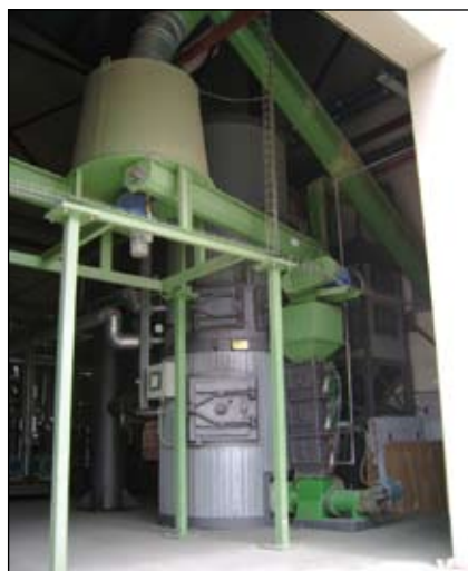
Figura 4.3: Caldera de biomasa de tecnología Sugimat.
