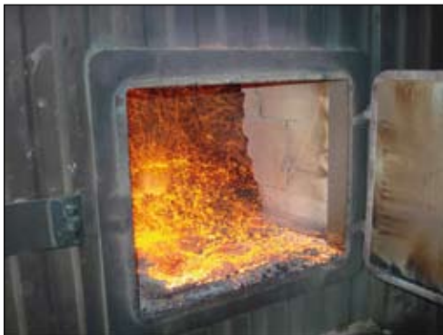
Figura 4.12: Caldera de biomasa para el secado del ladrillo.
