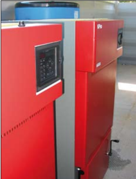
Figura 4.6: Calderas de biomasa de la granja porcina de Santa Cruz de la Zarza (Toledo).
