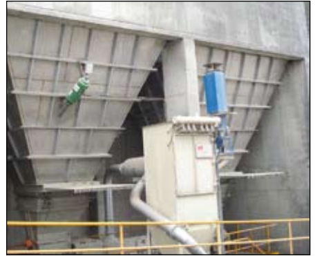
Figura 4.1: Silos de almacenamiento de coque y biomasa.
