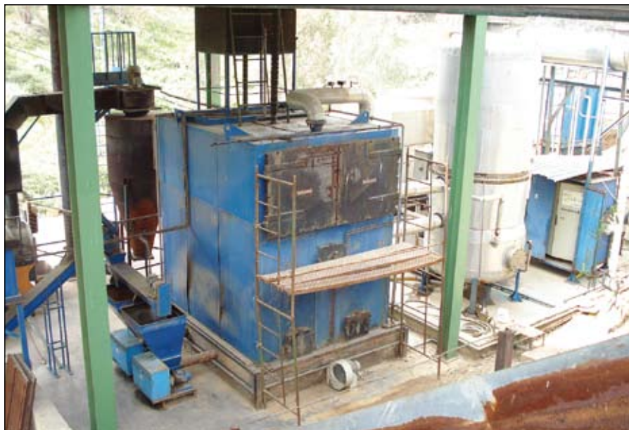
Figura 4.16: Caldera de biomasa con 3 MW de potencia.
