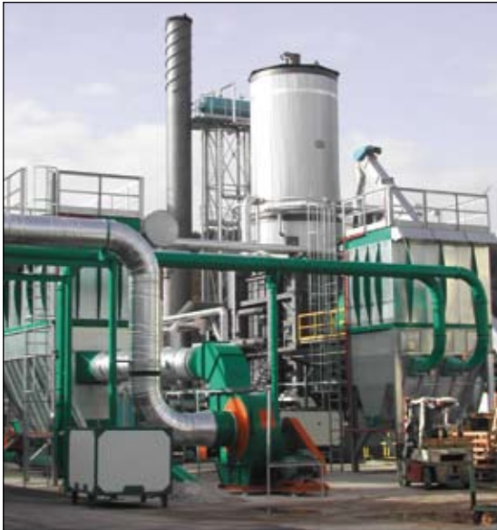
Figura 4.15: Caldera Sugimat en la planta de San Lorenzo de Yagüe.
