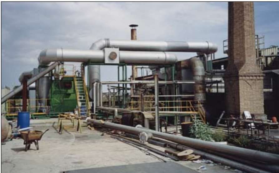
Figura 4.14: Instalación de Nesa en Alfara de Algimia.
