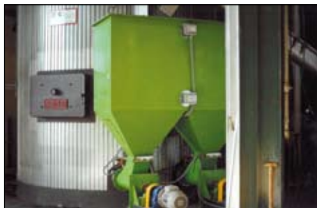
Figura 4.13: Cámara de combustión en la empresa Oleicota en Baeza.
