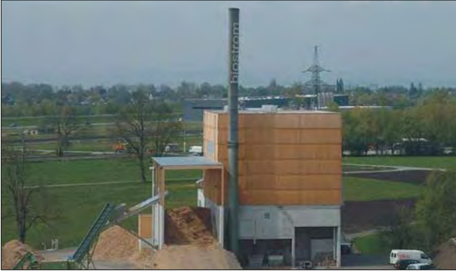
Planta de producción de energía térmica y eléctrica en Vorarlberg (Austria).
