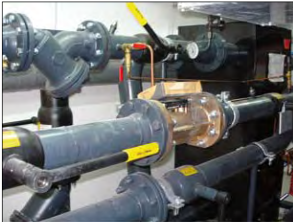
Subestación térmica que controla el consumo de energía térmica.
