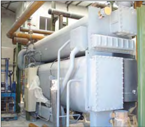
Máquina de absorción de Carrier de 2 MW instalada en el Parque Científico-Tecnológico.
