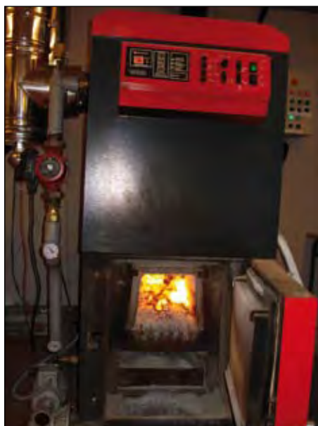
Caldera de biomasa que alimenta el equipo de climatización.
