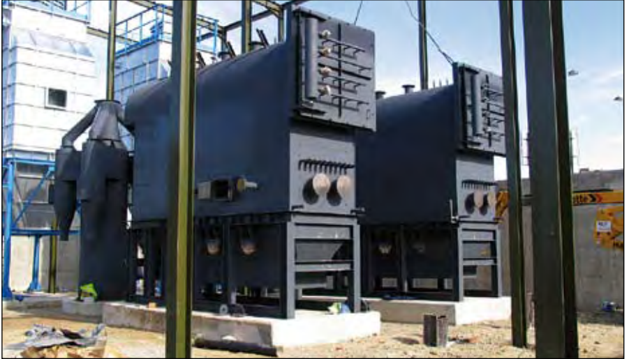
Calderas Bujo de agua caliente 2x3 MW térmicos de potencia con parrilla móvil para biomasa. Detrás se observan los multiciclones y los filtros de mangas.
