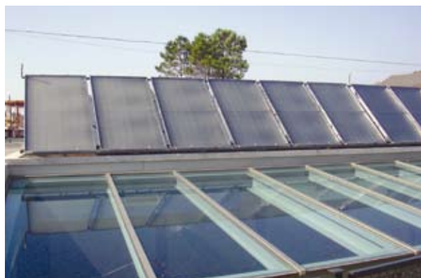
Figura 53: Campo de captadores solares
