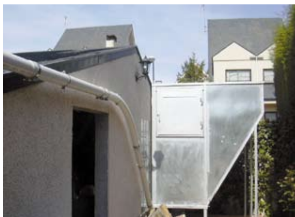
Figura 15: Tolva exterior con alimentación mediante tornillo sinfín
