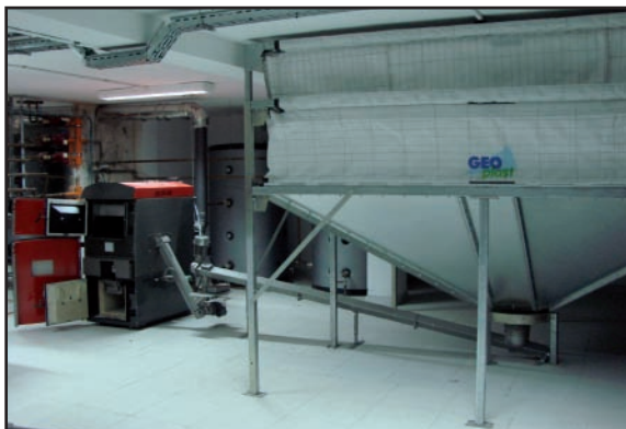
Silo de lona y alimentación a caldera del sistema de climatización (calor y frío por absorción). Casa de la Cultura de Viana de Cega (Valladolid).
