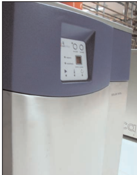
Una de las dos máquinas de absorción que forman parte del sistema de climatización de la Casa de la Cultura de Viana de Cega, Valladolid.
