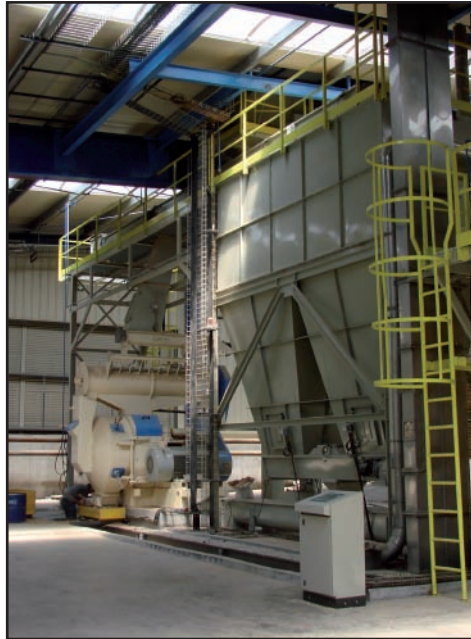
Equipos de enfriamiento y filtrado de aire y peletizadora de Ebepelet, Muxika (Vizcaya).
