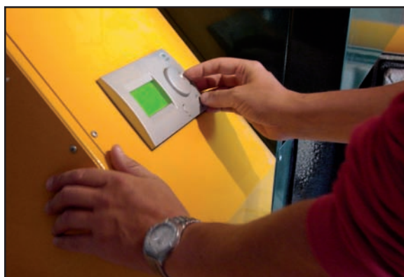
Interfaz de regulación y control de una caldera de biomasa de una vivienda unifamiliar.
