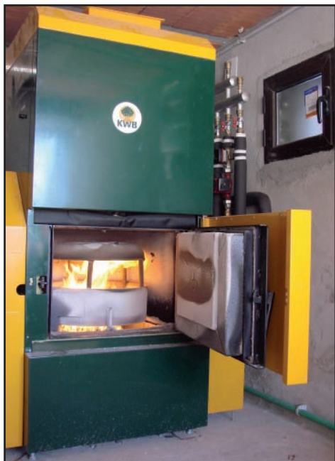
Caldera automática multi-combustible en funcionamiento en la Casa Rural del Caño, Muñopepe (Ávila).
