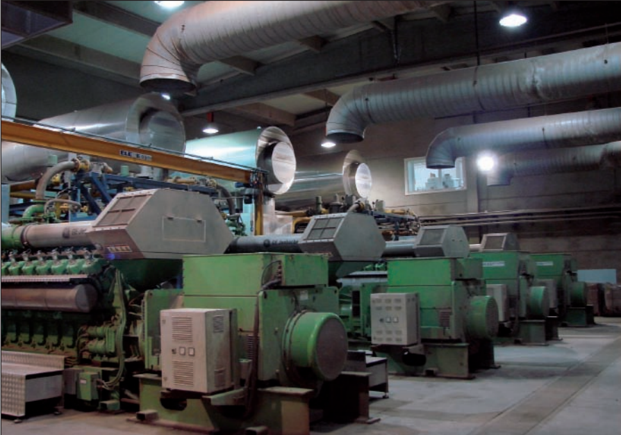
Motores para la generación de energía eléctrica.
